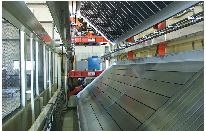
Bancos del Horno con Resistencias tipo Panel
